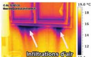
Défauts d'étanchéité du cadre
