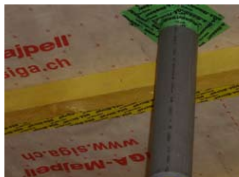
Soins apportés à l'étanchéité à l'air lors du passage de gaine dans le pare vapeur
