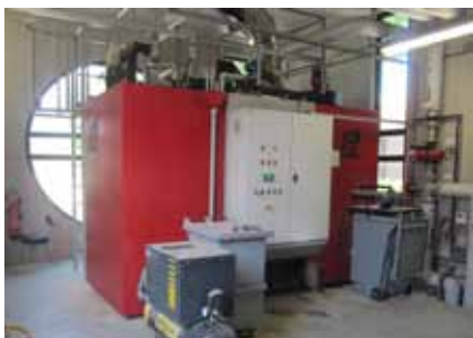
Chaufferie bois de Yenne (450 kW) Réseau de chaleur desservant 10 bâtiments de la commune.
